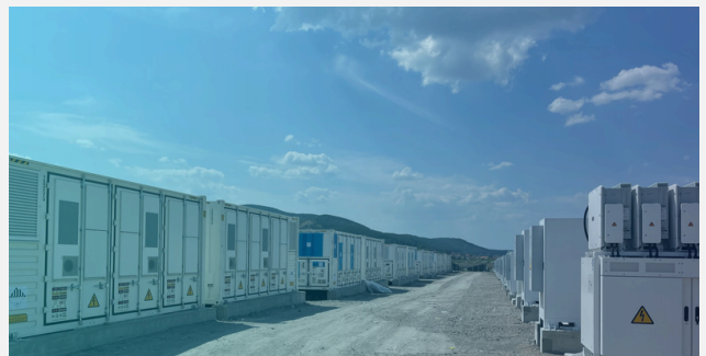
BESS Übergabestation AUX-Trafostation
